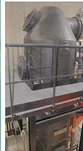
Le condenseur, en haut à droite les fumées sortent vers la cheminée, en bas à gauche, l'arrivée des fumées de la chaudière, photo FD
