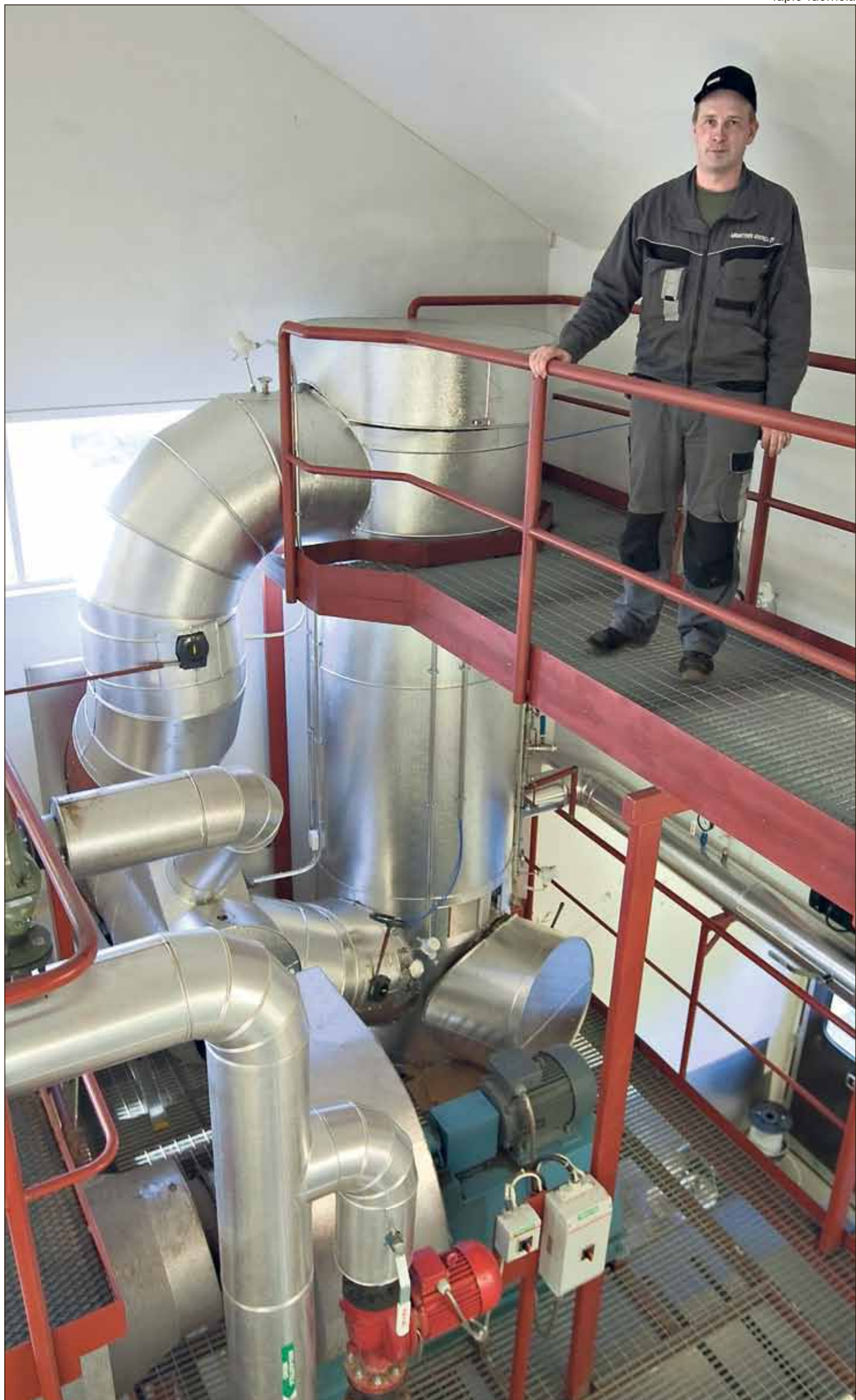
Kaasulauhdutin taittaa sekä kustannuksia että ilmansaasteita, tietää Simo Vehmaa.
